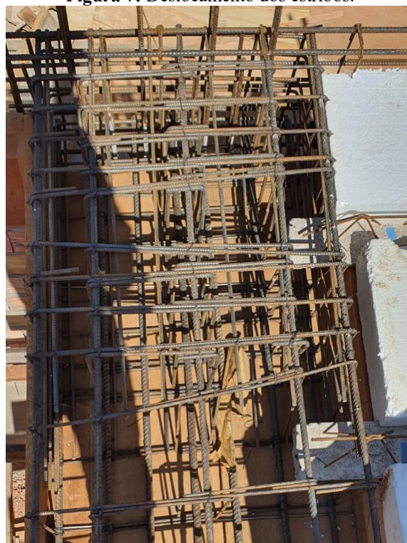
Figura 7: Deslocamento dos estribos.
