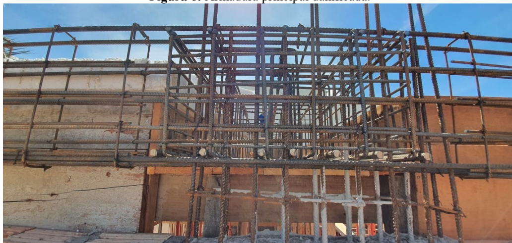
Figura 6: Armadura principal danificada.
