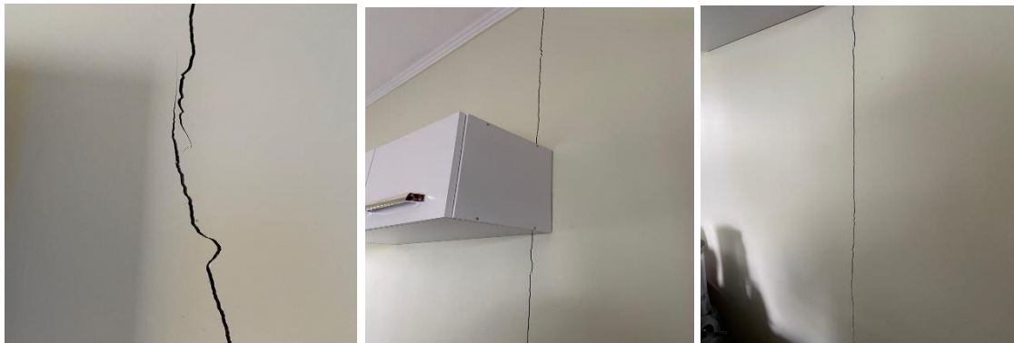
Figura 9: Levantamento na Casa n°01, Sra. Flávia Ribeiro. Fissuras e Rachaduras em Paredes
