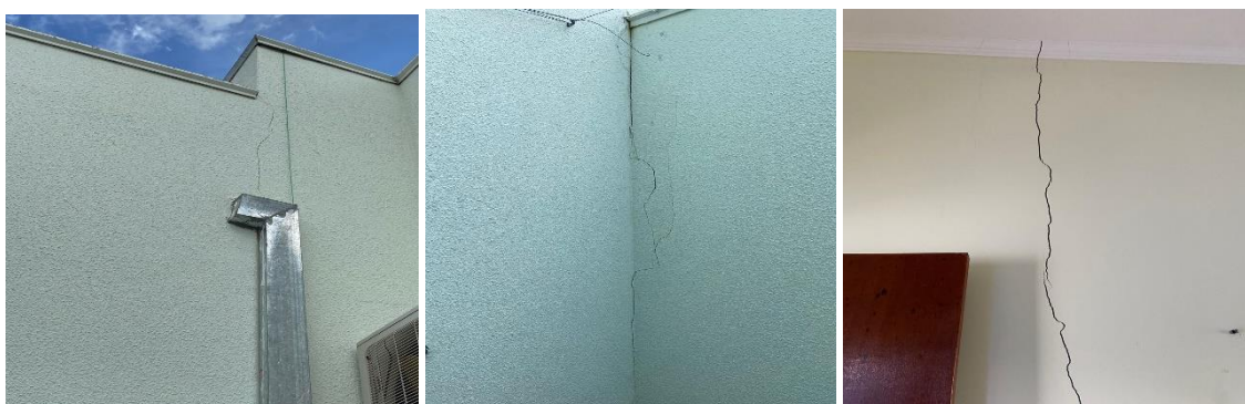
Figura 10: Levantamento na Casa n°02, Sr.ª Márcio Silva. Fissuras e Rachaduras em Paredes, internas, externas, muro de divisa
