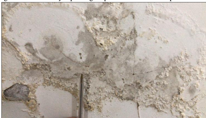
Figura 3: Manifestação patológica por eflorescência em parede interna
