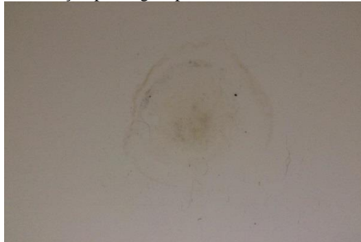
Figura 1: Manifestação patológica por umidade acidental em laje interna
