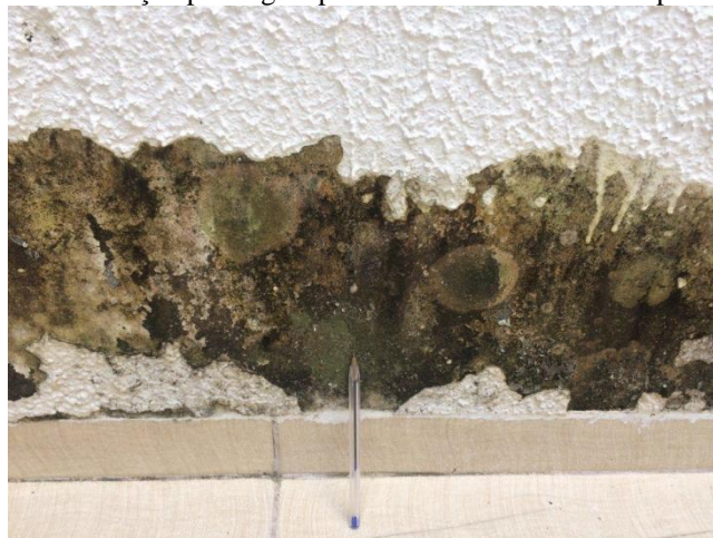
Figura 5: Manifestação patológica por umidade ascendente em parede externa
