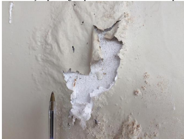
Figura 6: Manifestação patológica por umidade acidental em parede externa
