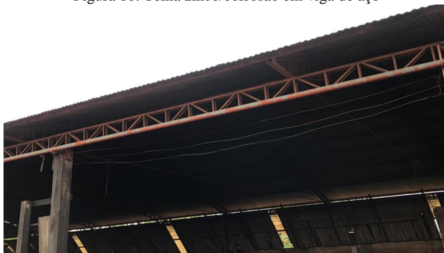
Figura 10: Telha zinco/corrosão em viga de aço
