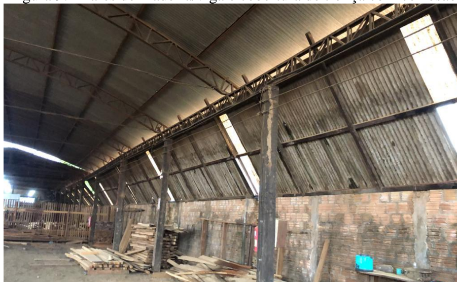
Figura 9: Pilares de madeira/viga e cobertura de treliça com corrosão
