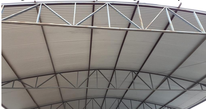
Figura 4: Corrosão na treliça/ Falha na geometria dos perfis
