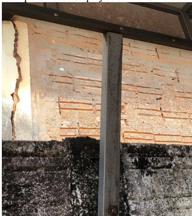
Figura 6: Incompatibilidade do projeto estrutural-Perda de resistência
