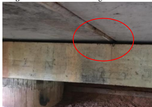
Imagem 24: Desnível entre vigas.
