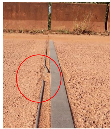
Imagem 16: Junta de dilatação.
