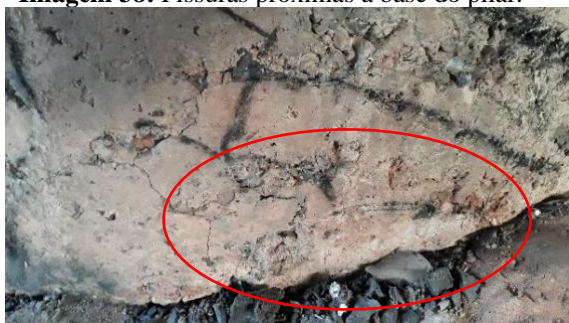
Imagem 38: Fissuras próximas a base do pilar.
