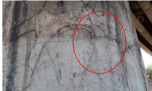
Imagem 37: Fissuras no pilar.
