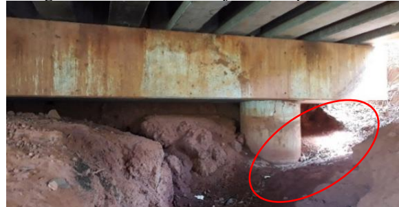
Imagem 22: Erosão do solo junto aos pilares.
