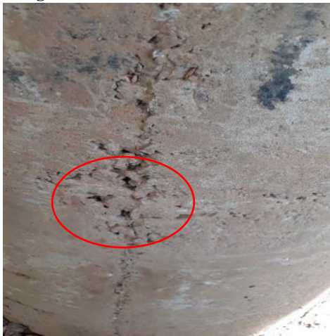
Imagem 45: Pilar com vazios no concreto.
