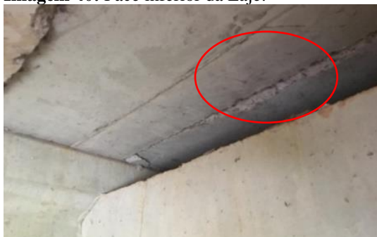
Imagem 40: Face inferior da Laje.
