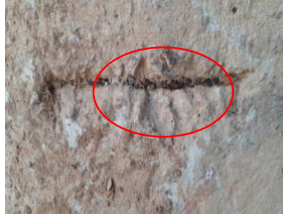
Imagem 49: Corrosão na armadura.
