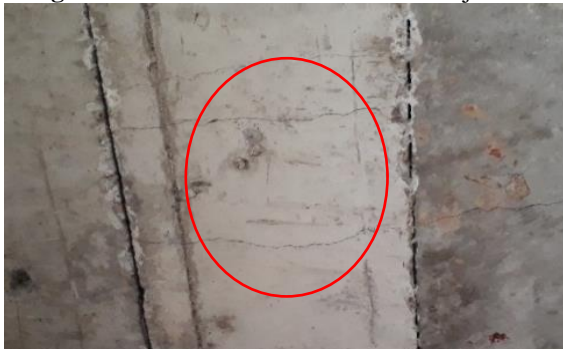
Imagem 36: Fissuras na face inferior da Laje.
