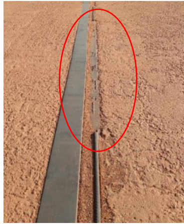
Imagem 15: Junta de dilatação.
