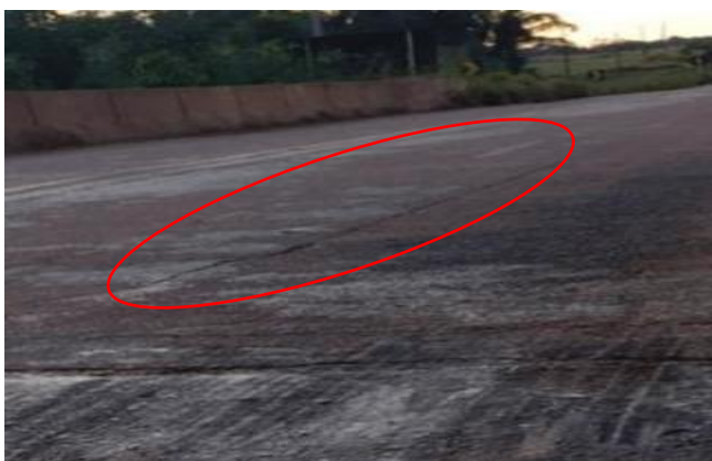
Imagem 25: Fissura no pavimento.
