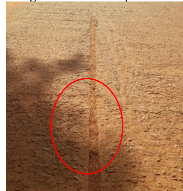
Imagem 13: Junta do pavimento.
