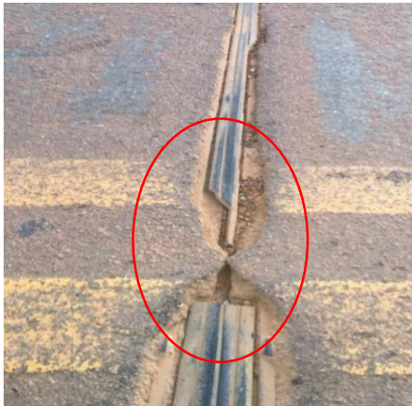
Imagem 17: Junta de dilatação.
