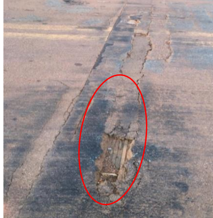
Imagem 18: Junta de dilatação.
