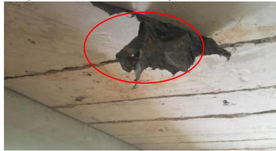
Imagem 28: Face inferior da laje.
