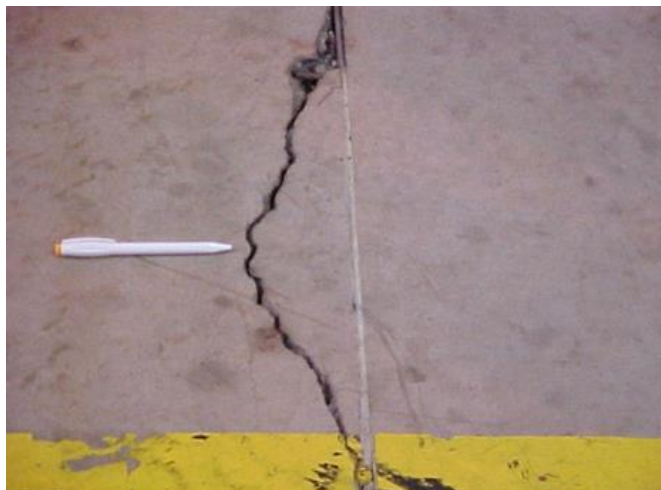
Figura 4: Fissuração no pavimento
