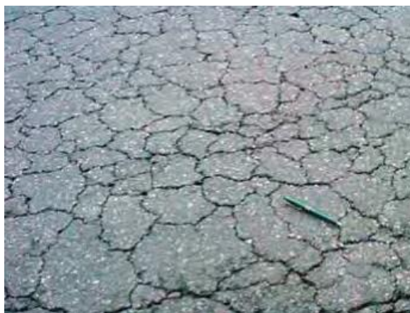
Figura 7: Trincas em malha tipo “couro de jacaré”
