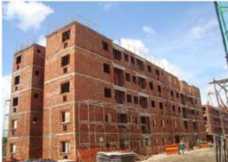
Figura 9: Obra em alvenaria estrutural do Programa Minha Casa Minha Vida em Fortaleza.
