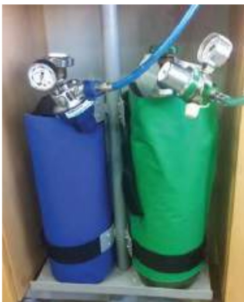
Figura 13: Tubos de óxido nitroso e oxigênio
